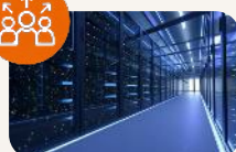
データセンター
